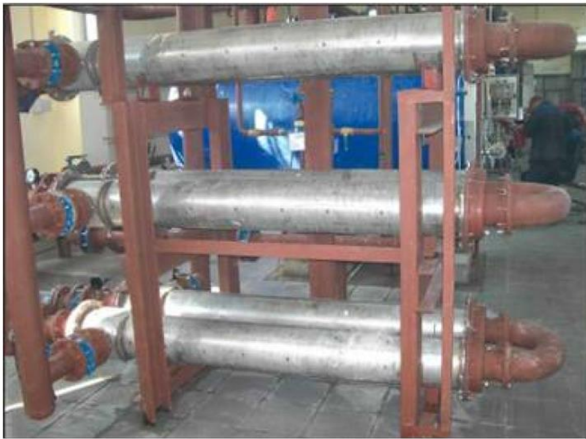
Рисунок 8. Теплообменники ВВПИ в котельной МУП «Теплосервис»
